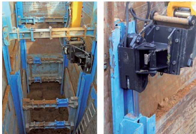
Figura 21 - Blindaggio con accoppiamento di due unità di blindaggio per grosse profondità (foto)
